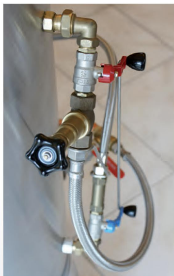
■ Tuyaux et robinets de remplissage
